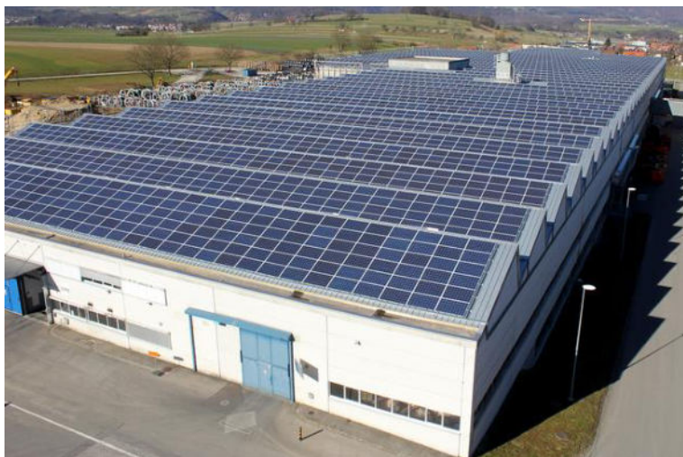
Abb. 3: Beispiel einer Photovoltaik-Anlage auf einer Fabrikhalle 9
