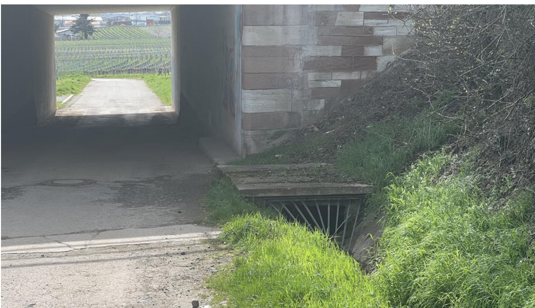
Abb. 300: Entwässerungseinrichtungen oberhalb der Autobahn
