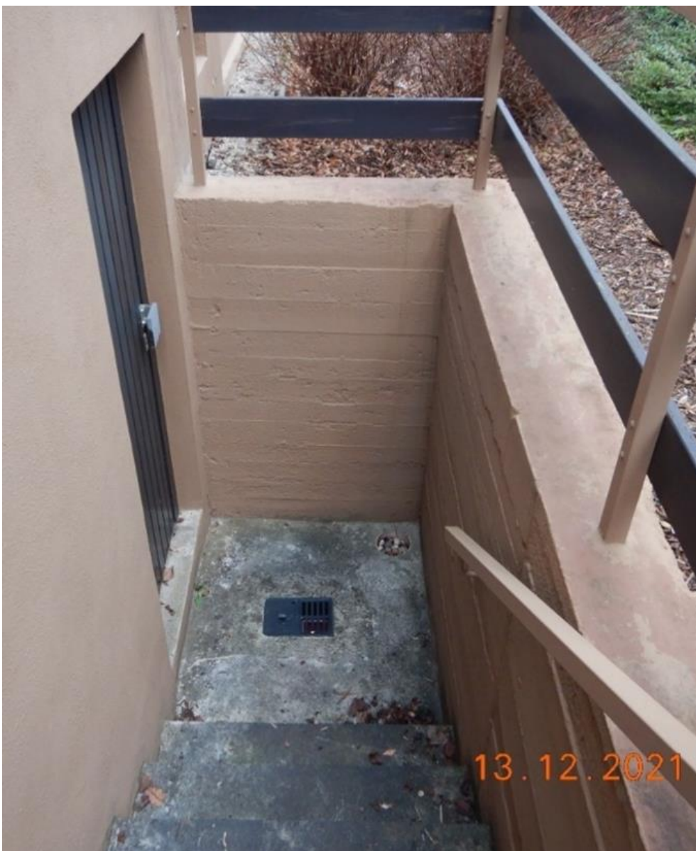
Abb. 328: Potenziell überflutungsgefährdeter außenliegender Kellerabgang
