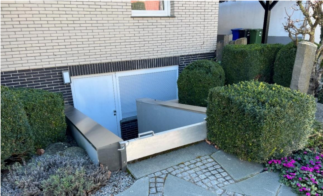
Abb. 234: Objektschutz in der Straße Hochgewanne
