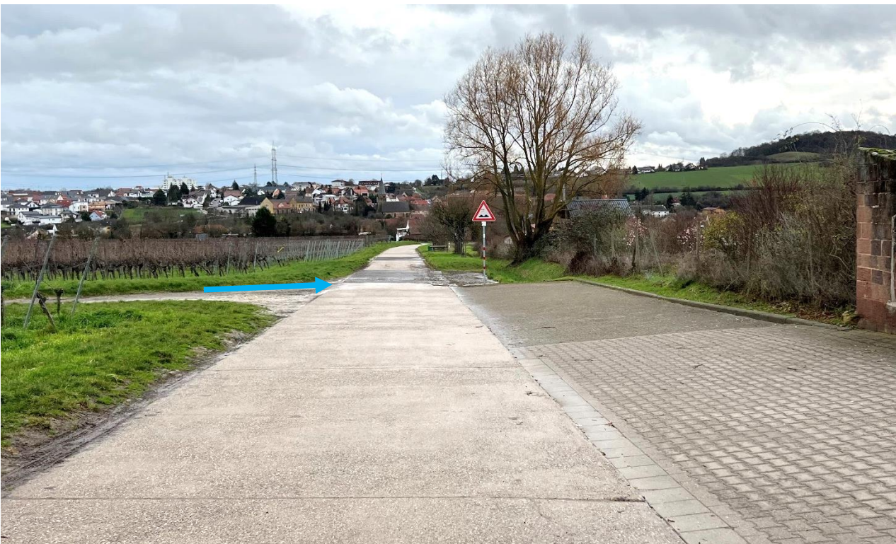
Abb. 121: Sandfang im Kützelsborn (oben) mit anschließender Verrohrungsstrecke (unten) und Zulauf von Osten
