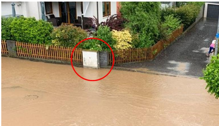
Abb. 6: Stromverteilerkasten in überfluteter Straße, Foto: NN, Stadtverwaltung
