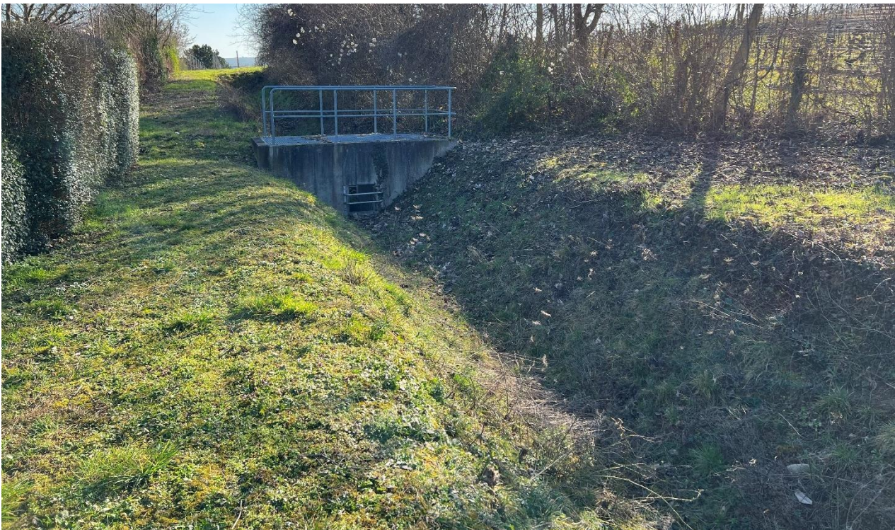
Abb. 220: Abfangegraben entlang der Bebauung „Im Freundchen“
