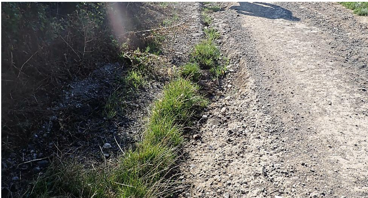
Abb. 26: Erosionsschäden im Einzugsgebiet
