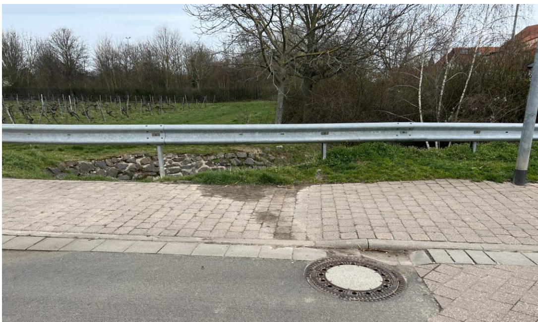
Abb. 289: Im Extremfall überstaugefährdeter Schacht vor dem Graben zum RRB 5
