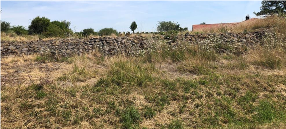
Abb. 115: Befestigte Dammscharte als Bauwerk zur planmäßigen Hochwasserentlastung mit Unterhaltungsbedarf (Zustand Sommer 2022)
