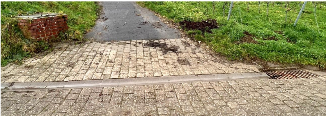
Abb. 101: Entwässerungseinrichtungen am Neuweg
