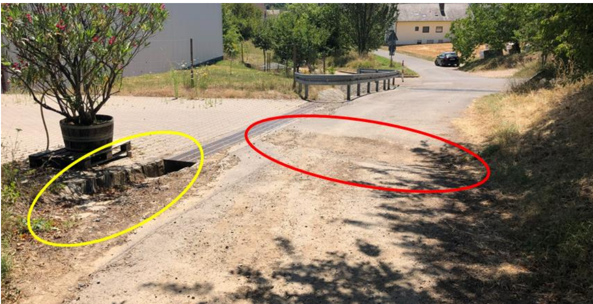
Abb. 129: Wegentwässerung mit Optimierungspotenzial
