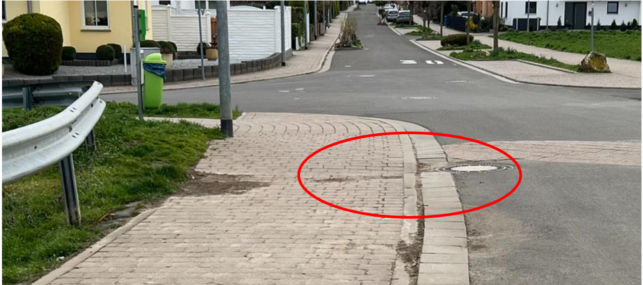
Abb. 288: Lücke in der Schwelle zur Raiffeisenstraße
