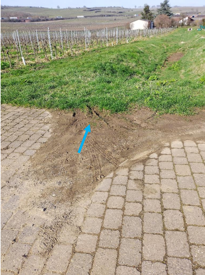
Abb. 266: „Regenrückhaltebecken Bärenbrunnenstraße“ von Süden mit nicht unterhaltenem Zulauf
