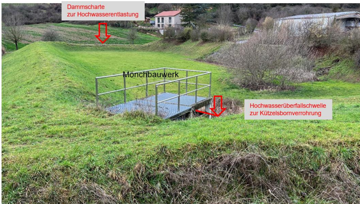
Abb. 114: Entleerungs- und Entlastungseinrichtungen am unteren RRB
