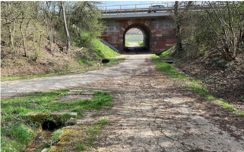
Abb. 283: Entwässerungssystem mit Gräben und Sandfängen oberhalb des Autobahndurchlasses
