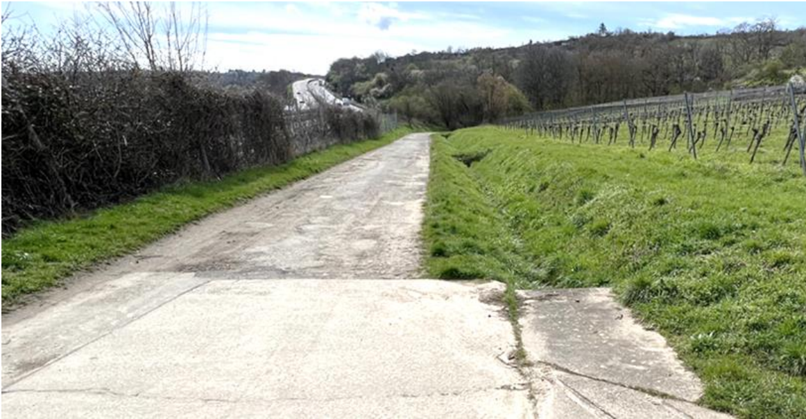
Abb. 279: Entwässerung des Wirtschaftswegs neben der Autobahn
