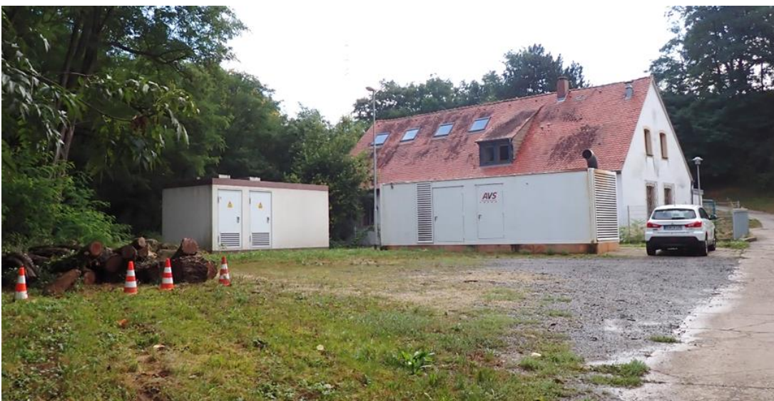
Abb. 154: Trafostation und Stromerzeuger neben dem Eisbach im überflutungsgefährdeten Bereich
