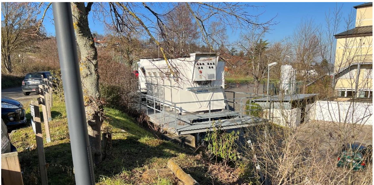
Abb. 194: Überflutungsgefährdete technische Ausrüstung des Krankenhauses
