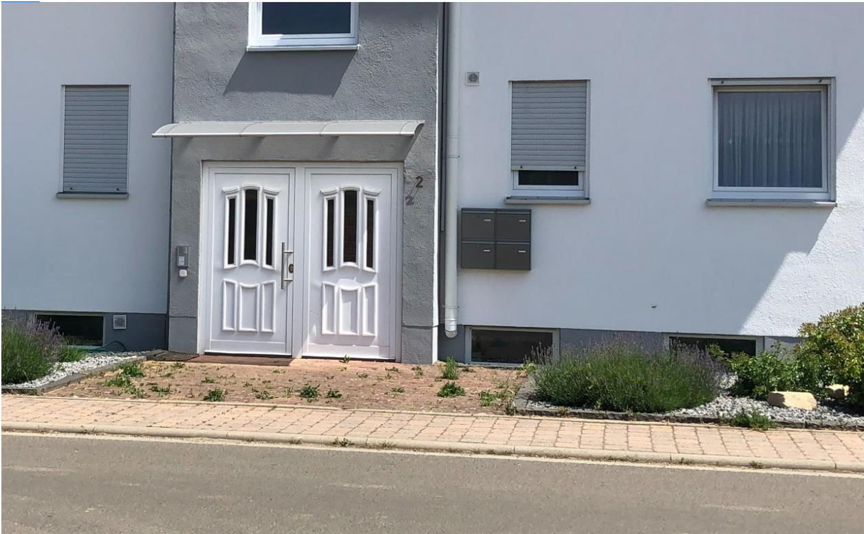
Abb. 35: Potenziell überflutungsgefährdetes Untergeschoss
