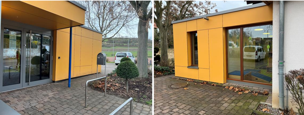
Abb. 91: Überflutungskritische Fenster und Türen an der Kita
