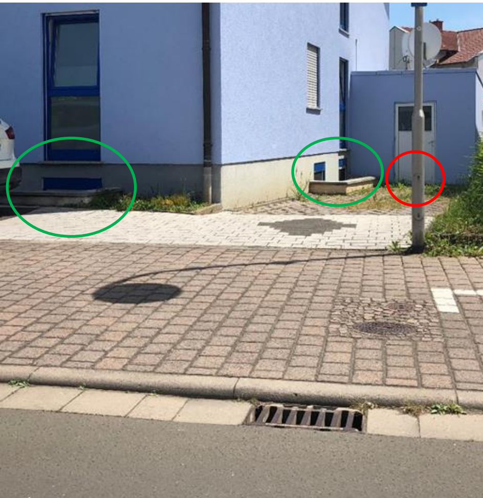
Abb. 38: Beispiel für die Sicherung von Fenstern im Untergeschoss
