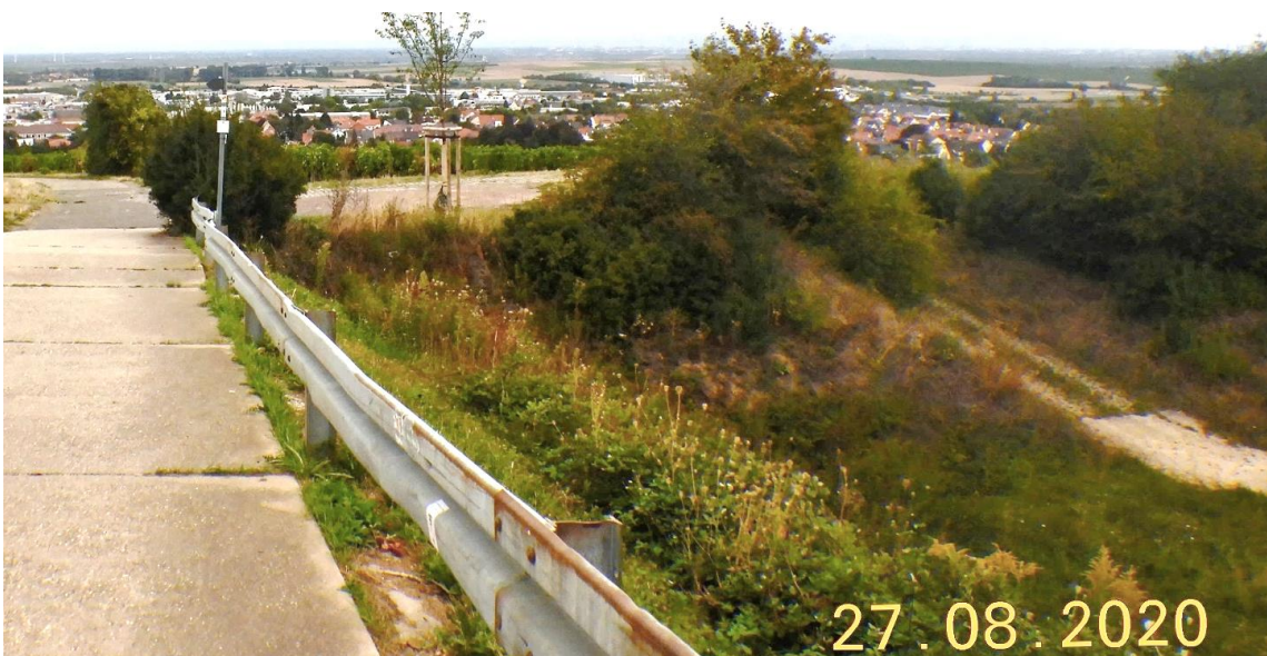
Abb. 24: Regenrückhaltebecken im Außengebiet
