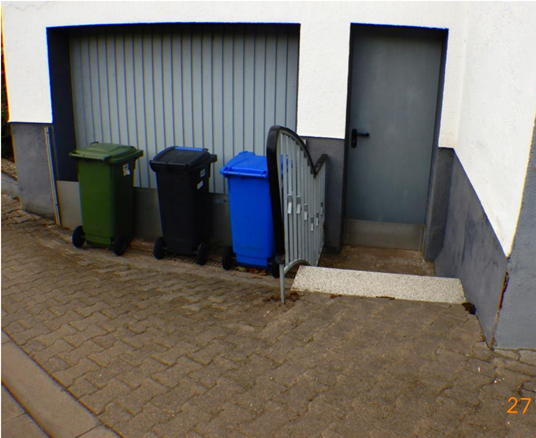
Abb. 33: Überflutungsgefährdeter Kellerzugang und Garagenzufahrt mit Objektschutz
